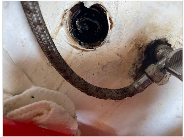
Abb. 6: Geöffneter Abwasseranschluss in der Wand: Leitung stark verkrustet und marode.
