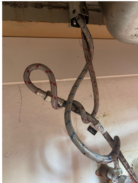
Abb. 4: Brauchwasser-Anschlusschläuche unter der Spüle: überalterte, mangelhaft verlegte Anschlüsse.
