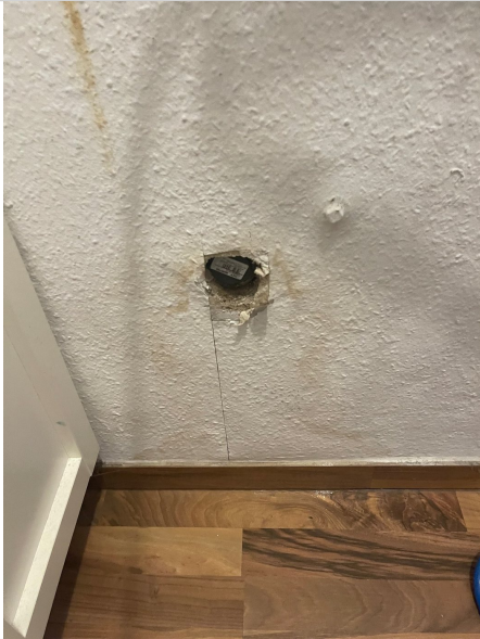
Abb. 1: 1. OG links: Lauf- und Feuchtespuren an der Wand im Bereich der Leitungsdurchführung.
