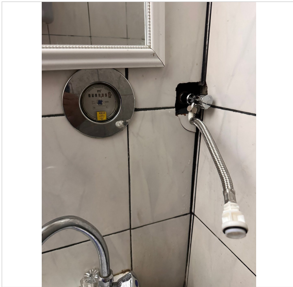
Abb. 10: WC der Ladeneinheit (EG): Unterputz-Wohnungswasserzähler; daneben provisorischer Leitungsanschluss (Zapfventil) zur Notversorgung.
