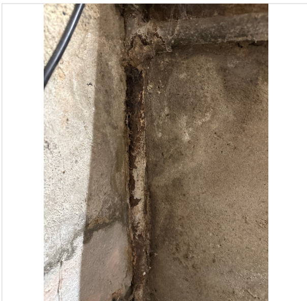
Abb. 12: Freigelegter Mauerschlitz: stark korrodierte Stahl-Zuleitung (Kaltwasser).
