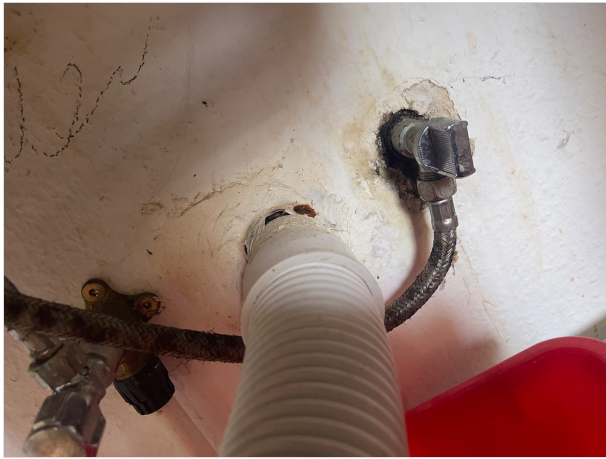
Abb. 5: Eckventil und Anschlussleitungen mit starker Verkalkung/Korrosion; Feuchtespuren an der Wand.
