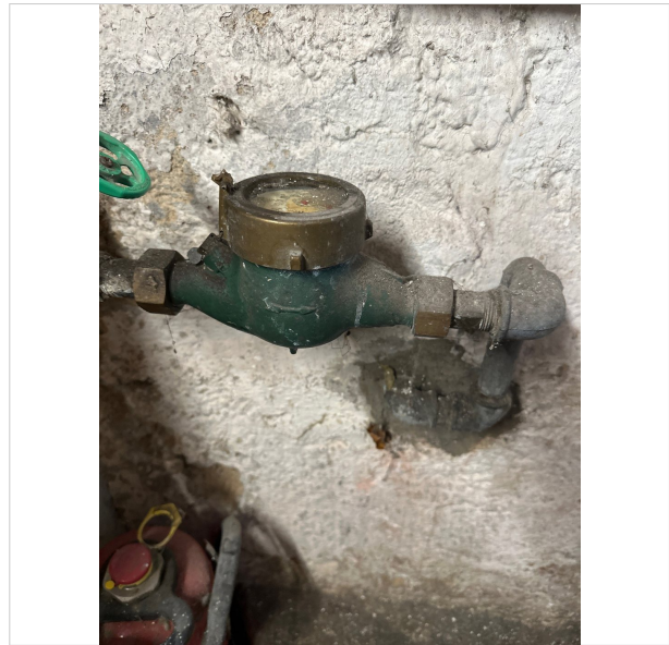
Abb. 11: Wasserzähler der betroffenen Kaltwasser-Zuleitung; starke Korrosion an Zähler und Verschraubungen.
