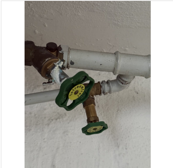
Abb. 3: Trinkwasser-Absperrungen in tottraumfreier Bauart (grüne Handräder, gelbe Plakette).
