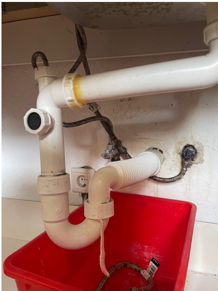
Abb. 3: Küchen-Unterschrank: Geruchsverschluss zur Überprüfung demontiert, Auffangwanne untergestellt.
