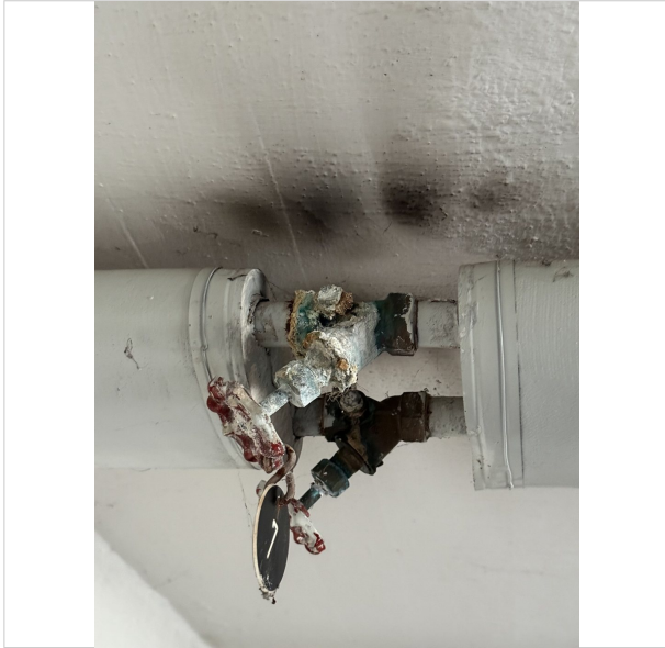
Abb. 2: Absperrung Kennz. „7“ – starke Korrosion/ Rostausblühung; Feuchtfleck an der Decke darüber.
